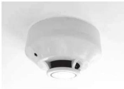
ก. อุปกรณ์ตรวจจับควัน
