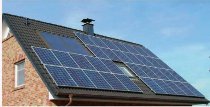
รูป แผงเซลล์สุริยะบนหลังคาบ้าน
